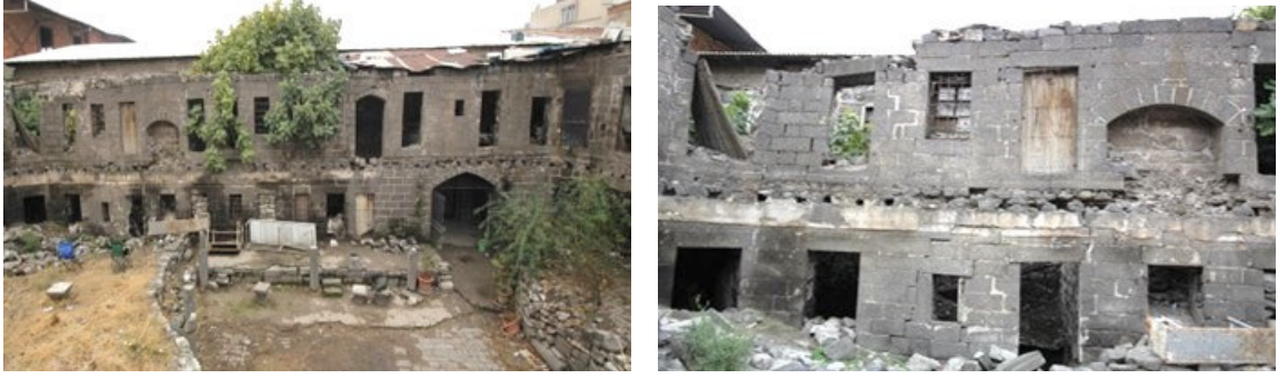
Şekil 7.Çifte Han güney cephesinde meydana gelen hasarlar ( 2023)
