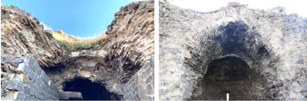
64- 65 numaralı burçlarda meydana gelen tuğla malzeme kayıpları (2023)
