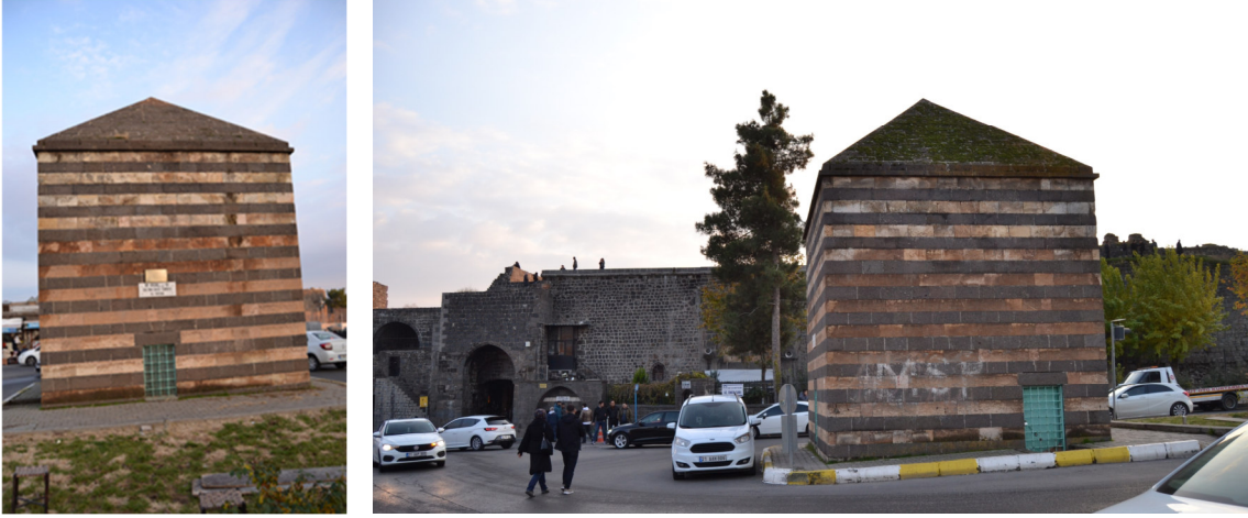
Şekil 23 Yapı yüzeyinde oluşan kirlenmeler
