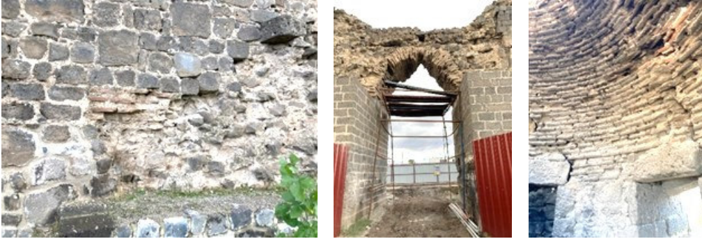
Şekil 9. Mardin Kapı-Yeni Kapı Arası Sur Duvarlarında Tuğla Malzemede Aşınma ve Yüzey Kayıpları (2023)
