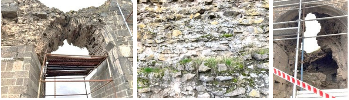
56 numaralı burç, 56-57 numaralı burçlar arasında bulunan duvar ve 58 numaralı burçlarda tuğla malzeme kaybı (2023)
