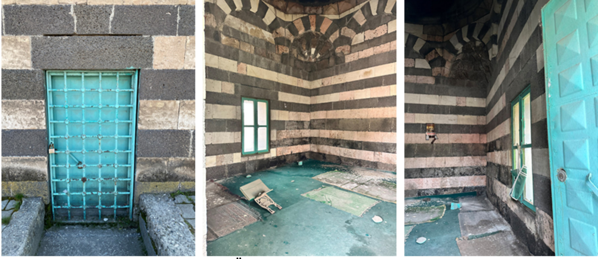
Şekil 25 Özgün yapıya aykırı müdahaleler
