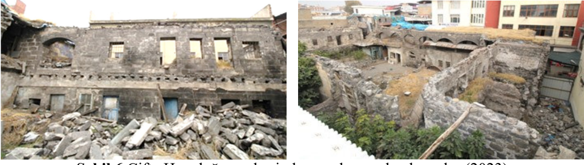
Şekil 6.Çifte Han doğu cephesinde meydana gelen hasarlar (2023)
