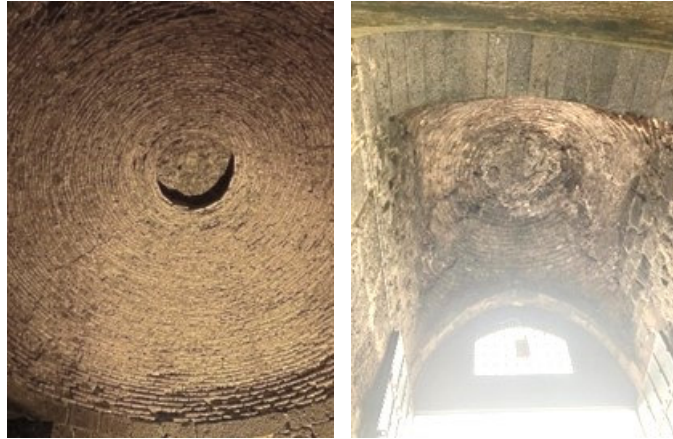
52 numaralı Keçi Burcu'nda tuğla kubbelerde çatlaklar (2023)
