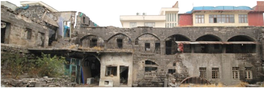
Şekil 8.Çifte Han kuzey cephesinde meydana gelen hasarlar (2023)
