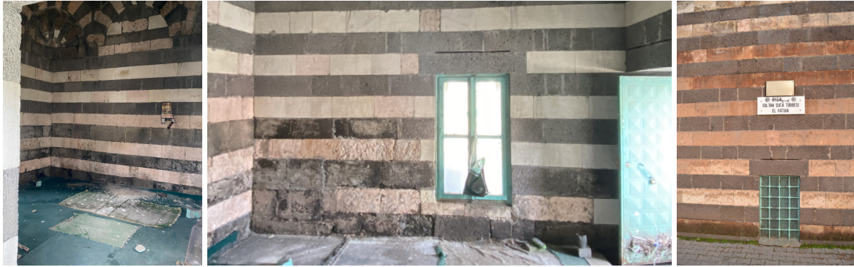
Şekil 18 Taş yüzeyinde oluşan hasarlar
