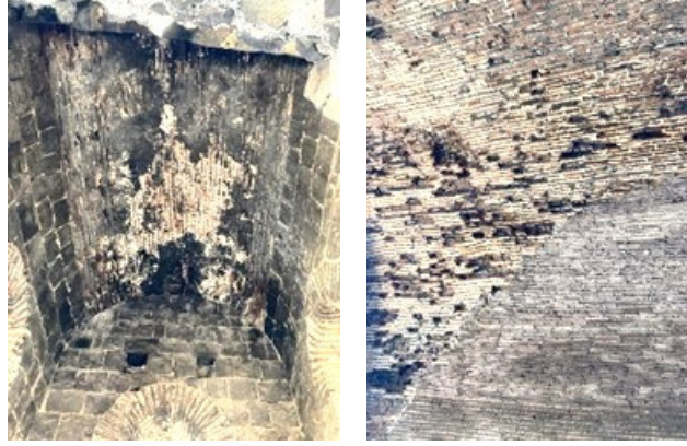
66-67 numaralı burçlarda meydana gelen tuğla malzeme kayıpları (2023) Şekil 7. Mardin Kapı-Yeni Kapı Arası Sur Duvarlarında Tuğla Malzeme Kayıpları (2023)
