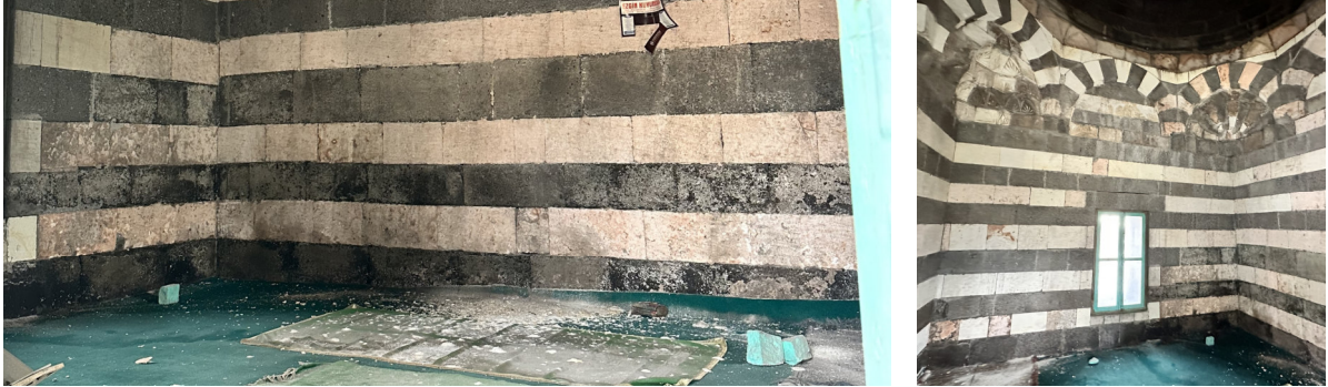
Şekil 20 Taş dokusunda oluşan tuzlanma hasarları
