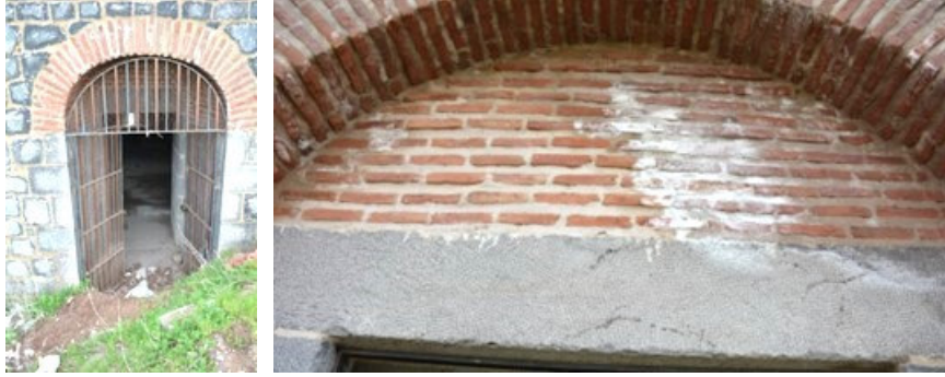
Şekil 11. 62 numaralı burçta meydana gelen tuzlanma (2023)
