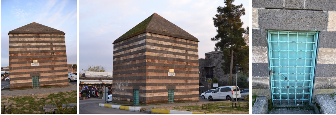
Şekil 22 Yapı çatısında ve duvar diplerinde oluşan bitkisel bozulmalar
