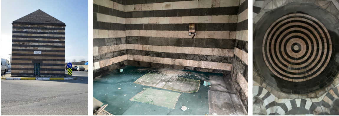
Şekil 24 Nemden kaynaklı oluşan hasarlar
